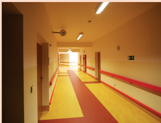
Ilustrativní fotografie č. 7.2 – Interiér chodby – špatné řešení
